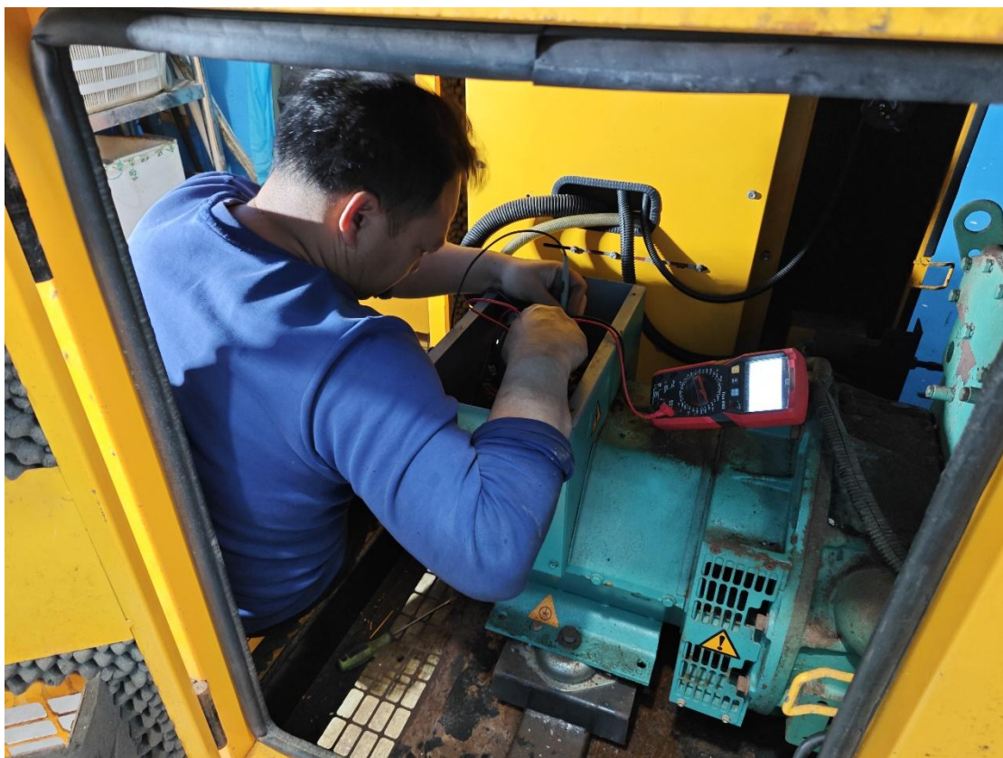
维修师傅正在检测柴油发电机
