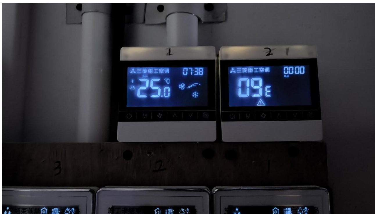
空调系统故障
